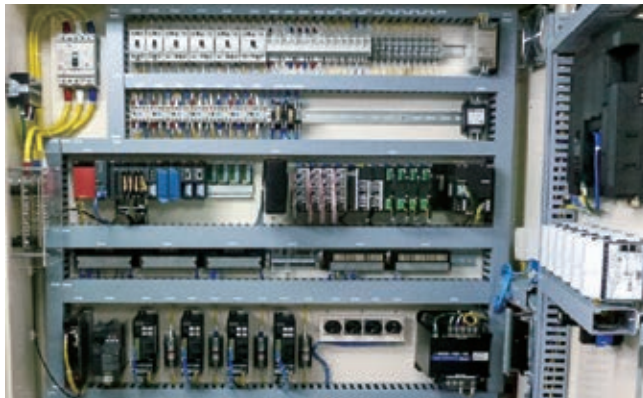
▲ 弊社設計の制御盤です。この制御盤で機械を制御します。
